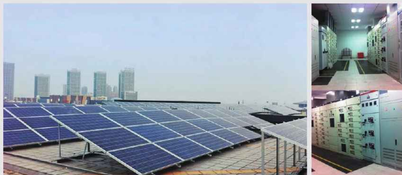
项目名称：武汉行政中心 - 500KW 屋顶光伏系统
