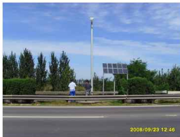
(唐港高速监控太阳能电源)
