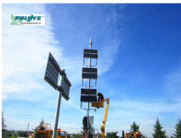
长沈高速监控 1200W 太阳能电源
